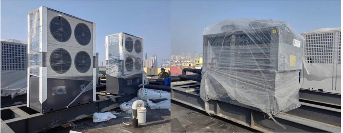
图6 屋顶空气源热泵 (图片来源:项目介绍. 2023 年10 月21日)
