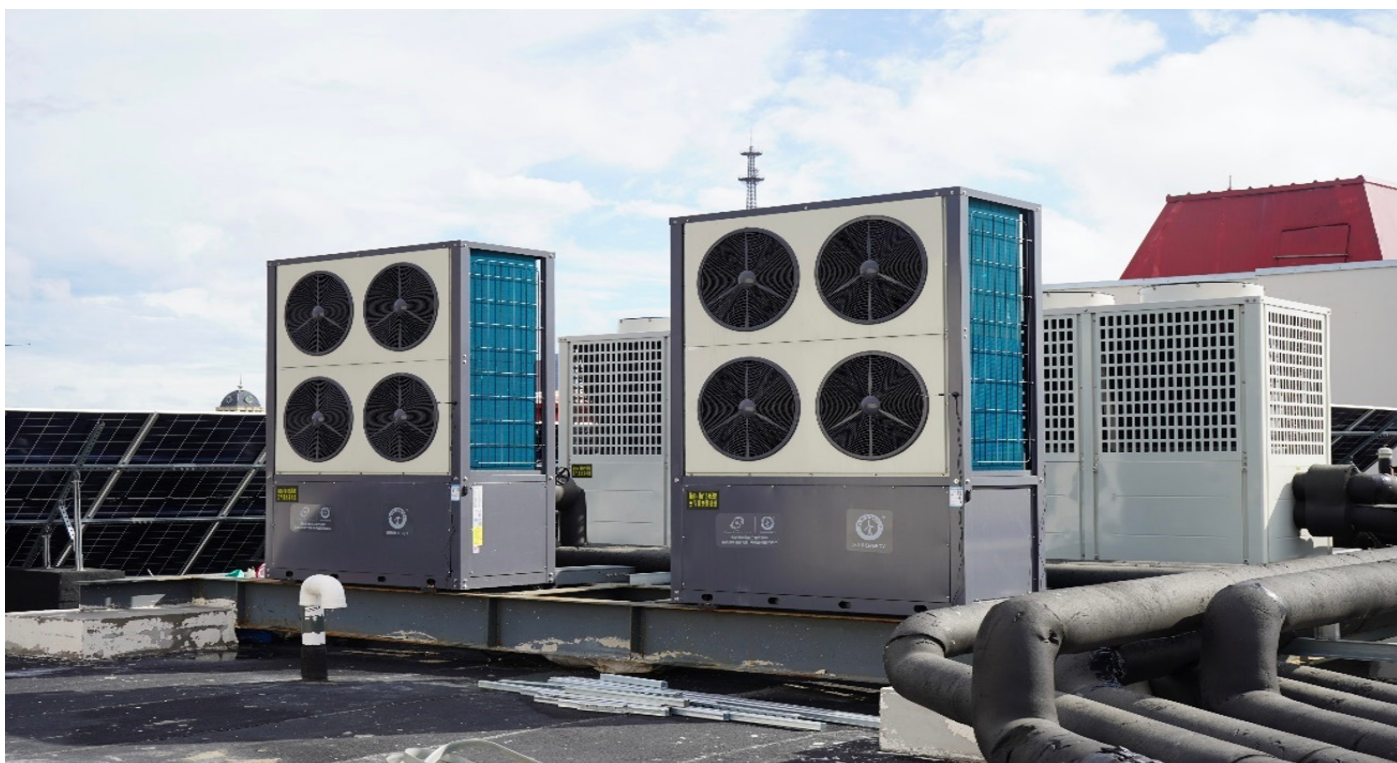
图15 改造后空气源热泵机组 (图片来源:示范工程方)
