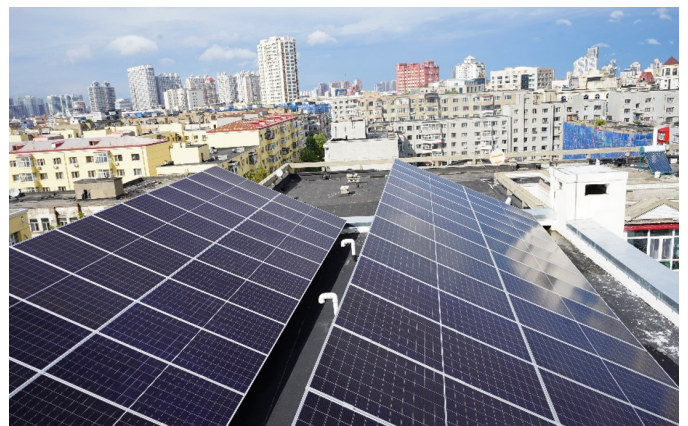
图13 太阳能板 (图片来源:示范工程方)
