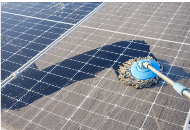
图6 光伏组件的表面灰尘会降低发电量,建议定期清洁 © AdobeStock
