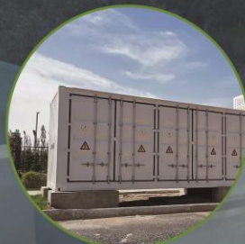
2MWh 储能集装箱
