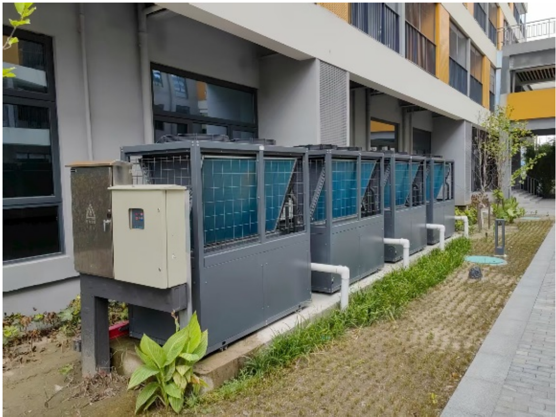
图 12 宿舍楼下空气源热泵
