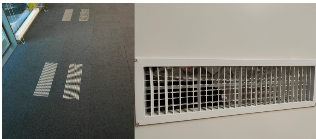
图 4 示范工程室内通风口（哪个示范工程？）
